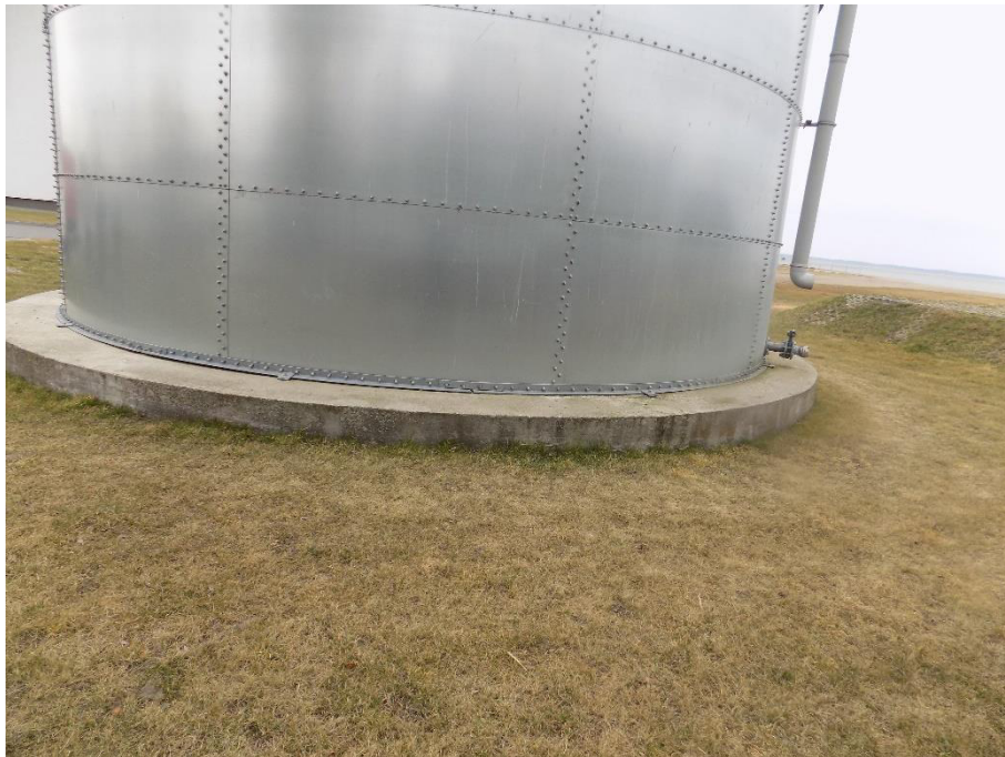
Brak ochrony odgromowej metalowego zbiornika wody pożarowej (Rzut terenu – odnośnik Pkt 1)
